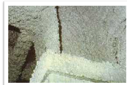
Particolare di mattoni contenenti amianto.
