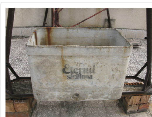
Serbatoio per l'acqua in eternit.
