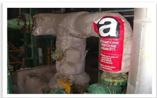
Condotte coibentate con amianto.
